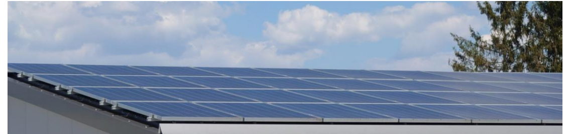
Energieversorgung mit Photovoltaik
